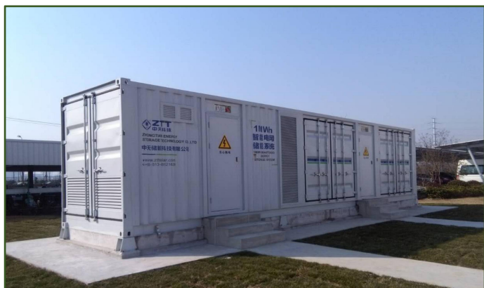
应用于储能电站
