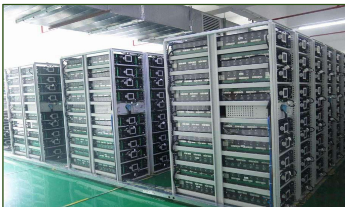
应用于UPS、基站备电
